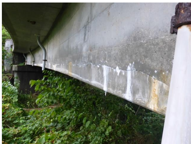
写真 1. 水平ひび割れ状況
