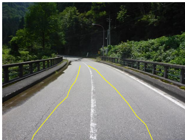
写真 2. 舗装のひび割れ状況
