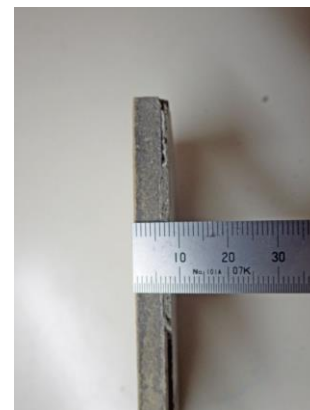
写真-6 張付けモルタルの厚さ不足
