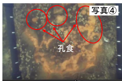
劣化度 b: L.W.L. 付近に孔食あり, 膨れやかさぶたのような腐食あり
