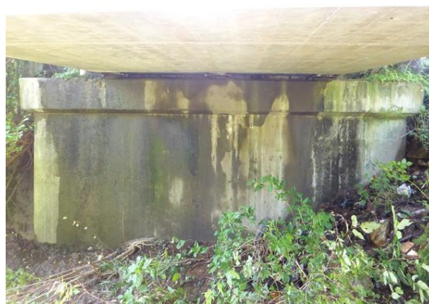
写真4. A1 橋台漏水状況
