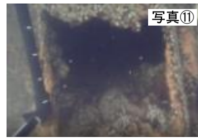
劣化度 a: 腐食による開孔あり, 裏埋め材が流出している兆候がある。
